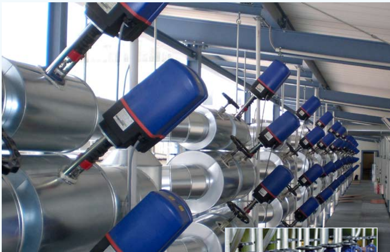
Planta de materiales de construcción en Breisach. Medio de calefacción: vapor, 16,5 barg, 250°C
