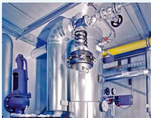
Tanque de agua de alimentación con desaireador para retornar condensado y agua fresca a la caldera
